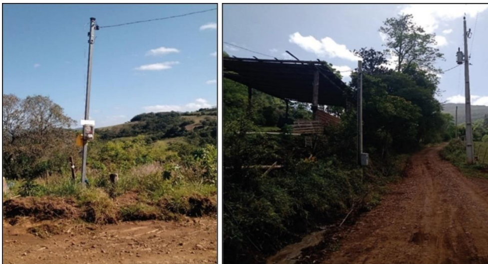
Figura 51: Postes de energia elétrica no acesso ao empreendimento na Estrada do Bom Retiro.
